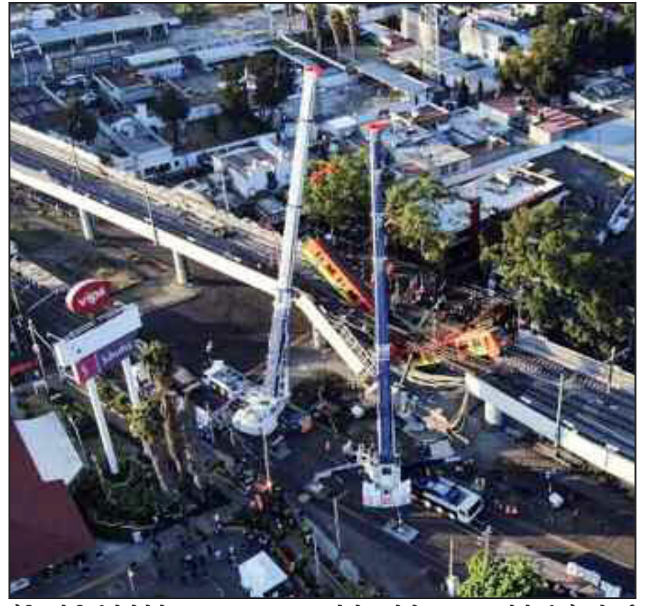
मैक्सिको सिटी में मेट्रो के पुल का एक खंभा ढह जाने से मलबे में दबकर 23 लोगों की मौत हो गई।
